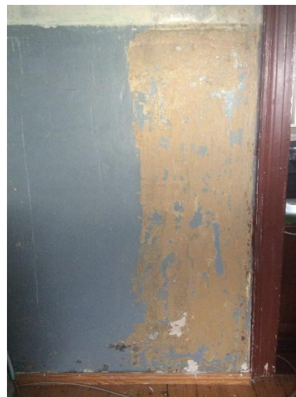
5 Der im Text beschriebene beschädigte Teil des Ölfarbenpanels
