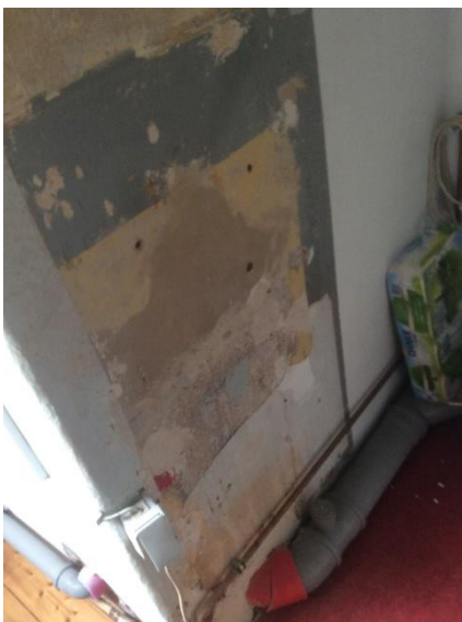
4 Die Wand zur Außentoilette. Dies ist der Bereich, der vorrangig bearbeitet werden soll.
